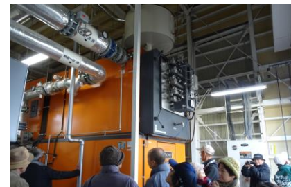
山形最上町バイオマスボイラー
