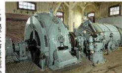
三居沢発電所の水車発電機。1924年製の発電機は3代目。今も稼働を続ける
