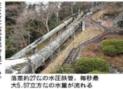
落差約27mの水圧鉄管。毎秒最大5.57立方mの水が流れる
