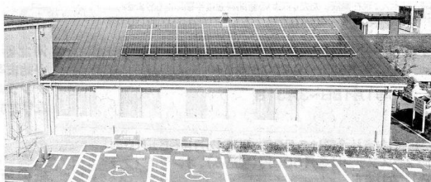
中新田公民館の屋根に設置された太陽光発電パネル
